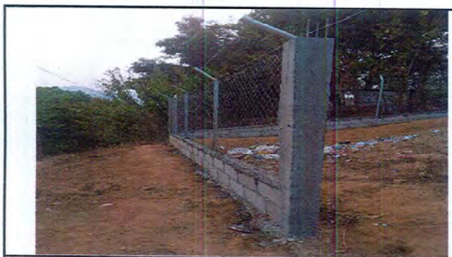
Foto 5: se observa el cambio de la malla de circulación en la parte de atrás del establecimiento.
